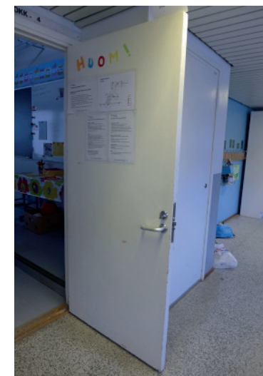
Luokan ovi on huoltamaton. Ovien heloitus on uusittu. LA
